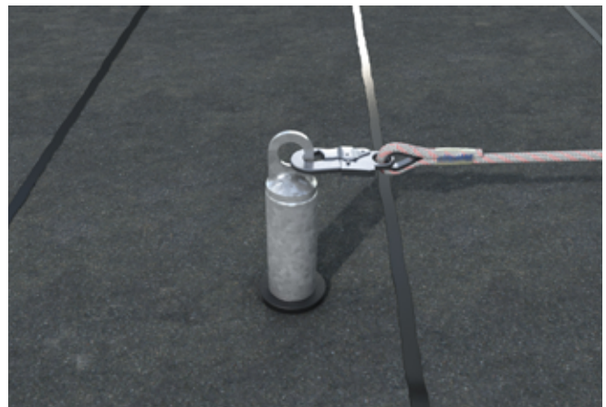
Abb. 57 Beispiel einer Anschlageneinrichtung, die dauerhaft am Bauwerk befestigt ist (Einzelanschlagpunkt-Stahlrohrstütze).
